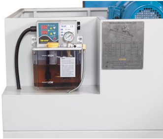
Eine Zentralschmierung versorgt alle Schmierstellen einer Maschine automatisch und kontinuierlich mit dem erforderlichen Schmierstoff. Ein zentraler Behälter speichert den Schmierstoff, der über ein Leitungssystem zu den einzelnen Schmierstellen verteilt wird. Die Dosierung erfolgt elektronisch geregelt
